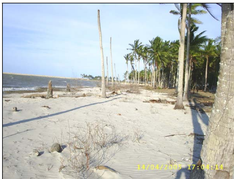
รูปที่ 1-1 สภาพการกัดเซาะฝั่งบริเวณชายฝั่งตอนบนเขื่อนกันทรายร่องน้ำต้นหยงเปาว์
