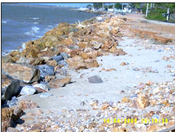
ข. สภาพการกัดเซาะและแนวหินทิ้ง ป้องกันชายฝั่ง บริเวณบ้านบะอิ่ง ถึงบ้านสายหมอ (หาดรัชดาภิเษก)
