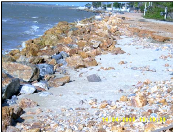
รูปที่ 2 สภาพการกัดเซาะและแนวหินทิ้งป้องกันชายฝั่ง บ้านปะอิง (หาดรัชตาทิเชก)
