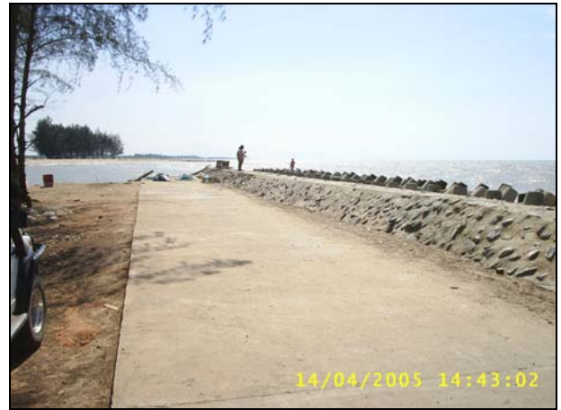
รูปที่ 3 สภาพการกัดเซาะด้านเหนือกำแพงกันคลื่นบ้านบางตาวา
