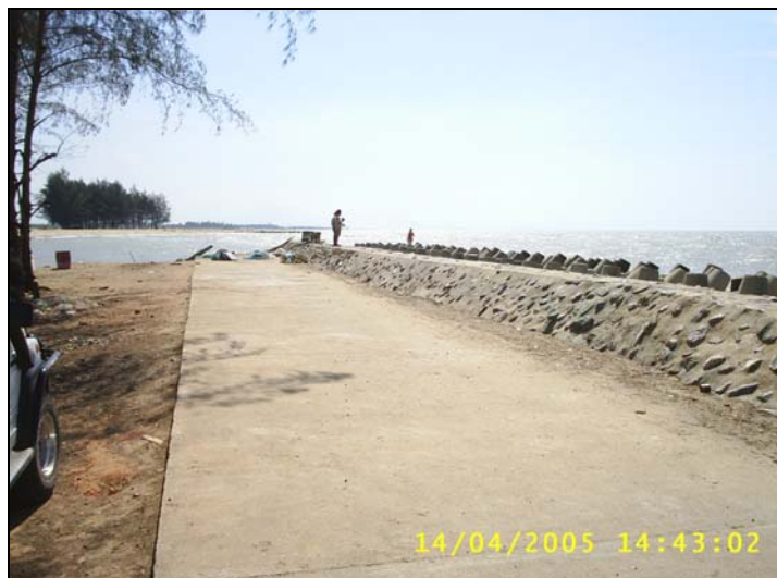
รูปที่ 3 สภาพการกัดเซาะด้านเหนือกำแพงกันคลื่นบ้านบางตาва
