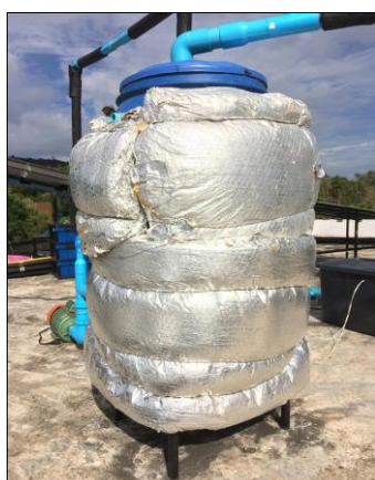
(ก) ถังเก็บน้ำร้อน
