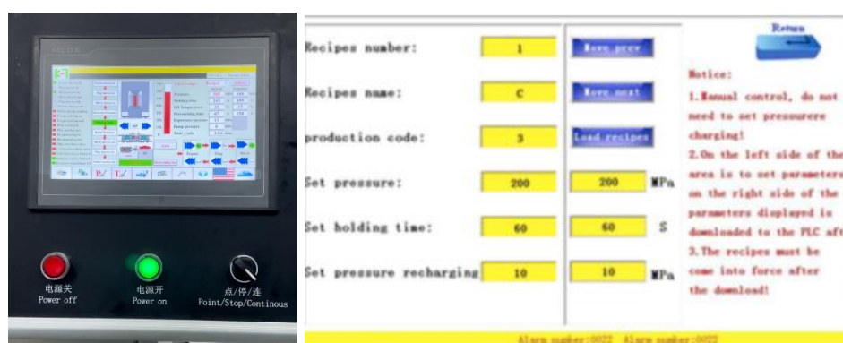
ภาพที่ 4.17 หน้าจอบควบคุม
