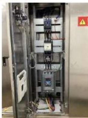
รูปที่ 4.34 ตู้ควบคุมไฟฟ้า
