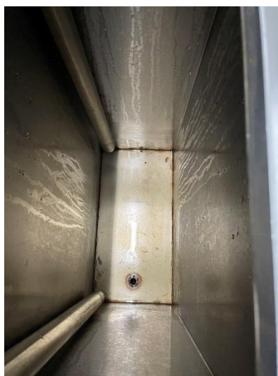
ภาพที่ 4.27 ถังน้ำ (Water tank)
