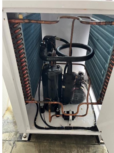
ภาพที่ 4.25 เครื่องระบายความร้อนน้ำมัน (Oil Cooling)
