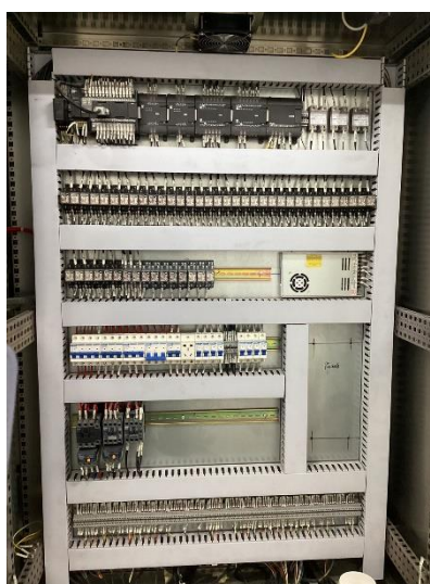
ภาพที่ 4.20 ตู้ควบคุมไฟฟ้า
