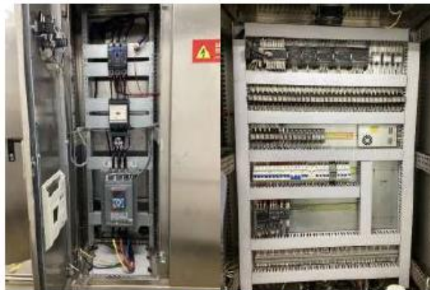
รูปที่ 4.12 ตู้ควบคุมไฟฟ้า
