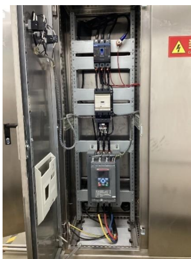
ภาพที่ 4.40 ตู้ควบคุมไฟฟ้า
