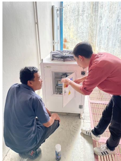
ภาพที่ 4.26 ตู้ควบคุมเครื่องระบายความร้อนน้ำมัน (Oil Cooling)
