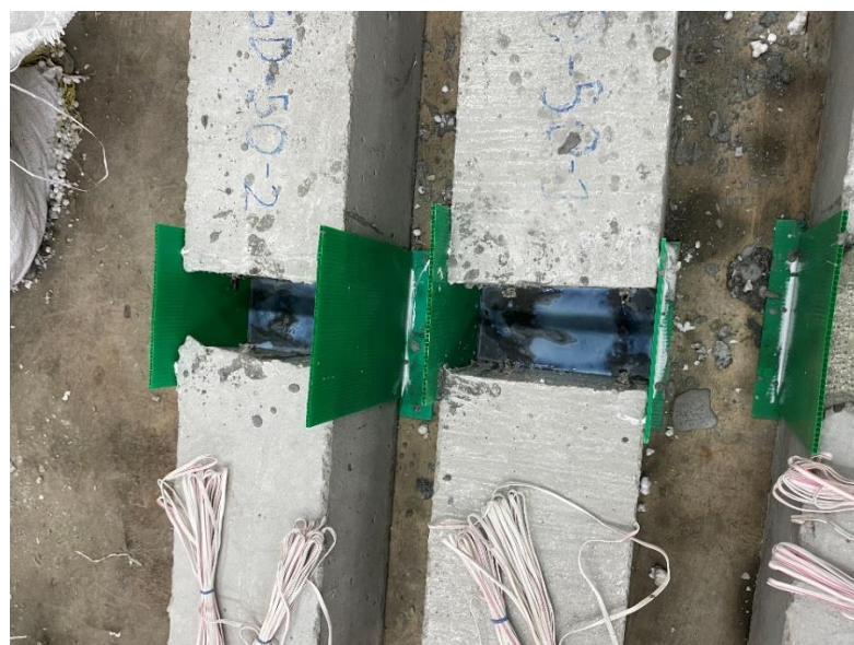
รูปที่ 3.14 การทาน้ำยาเชื่อมประสานคอนกรีต
