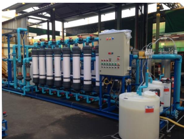
รูปที่ 2.4 ระบบกรองน้ำแบบ UF (Ultra Filtration System)
