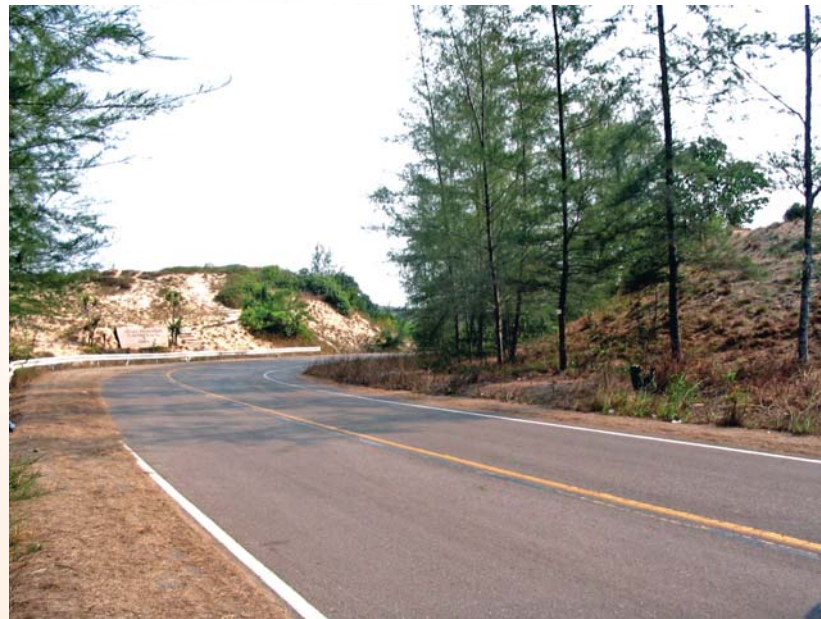
ภาพที่ 33 การสร้างถนนบริเวณสันทรายชายฝั่ง ในจังหวัดชุมพร
