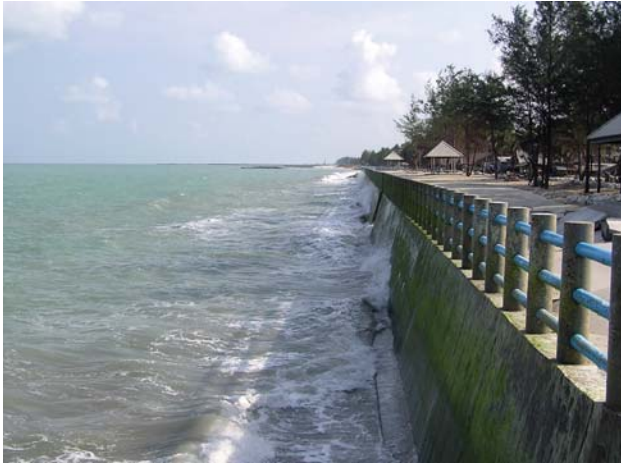
ภาพที่ 59 กำแพงกันตลิ่งแบบแนวตั้งบริเวณชายฝั่งบ้านหน้าศาล ต.หน้าสตน อ.หัวไทร จ.นครศรีธรรมราช
