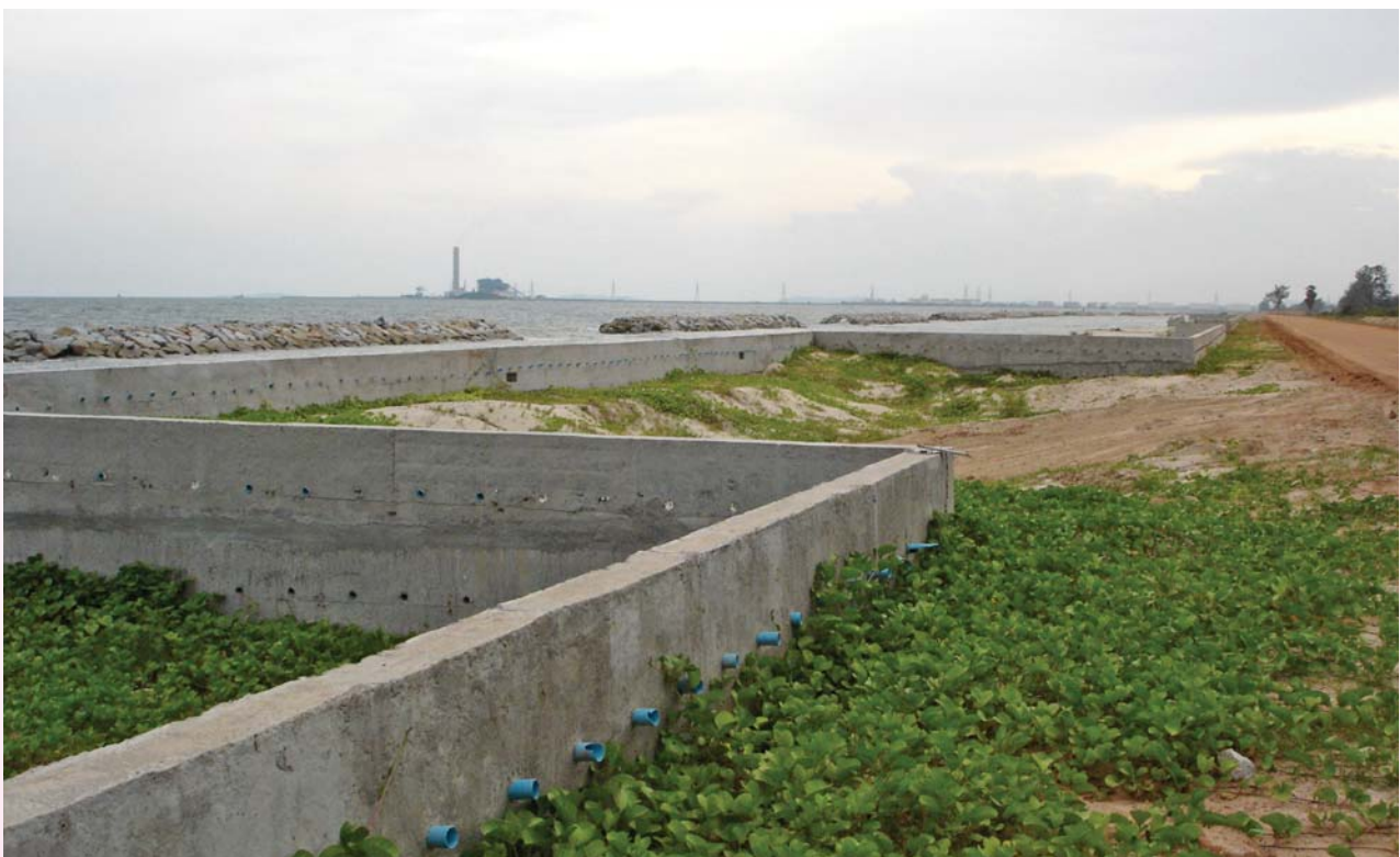
ภาพที่ 61 กำแพงกันตลิ่งแบบแนวตั้งบริเวณหาดแสงจันทร์ ต.เนินพระ อ.เมือง จ.ระยอง
