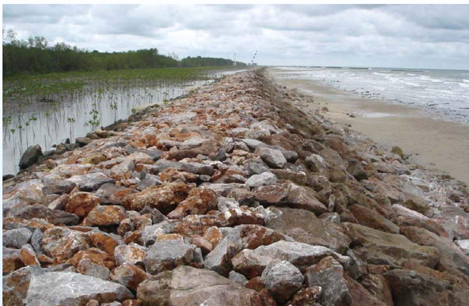
ภาพที่ 42 เขื่อนป้องกันคลื่น บริเวณชายฝั่งแหลมหลวงศรีสอรัท ต.แหลมผักเบี้ย อ.บ้านแหลม จ.เพชรบุรี
