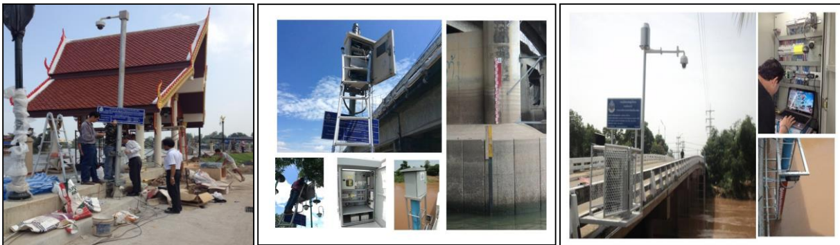
รูปที่ ๔-๑๕ การตรวจสอบ บำรุงรักษาระบบตรวจวัดสภาพน้ำทางไกลอัตโนมัติ (Telemetry System)
