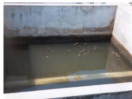
น้ำทิ้งที่ได้มาตรฐานจากระบบบำบัดน้ำเสีย
