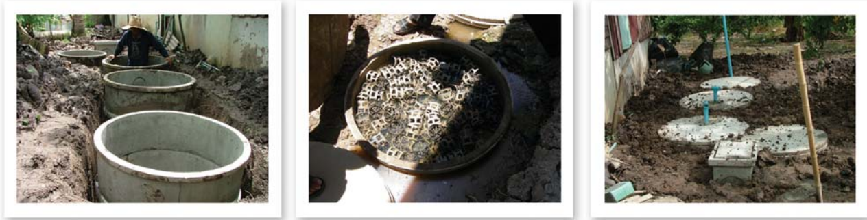
การก่อสร้างระบบบำบัดน้ำเสียในพื้นที่บึงพระอาจารย์ จังหวัดนครนายก
