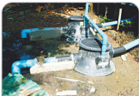
รูปที่ 3 ระบบบำบัดน้ำเสียแบบกรองชีวภาพแบบไร้อากาศบริเวณเกาะลันตา
