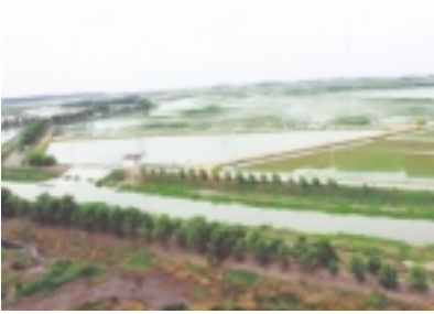
รูปที่ 3 ระบบบำบัดน้ำเสียแบบบ่อผึ่ง (เทศบาลนครหาดใหญ่)
