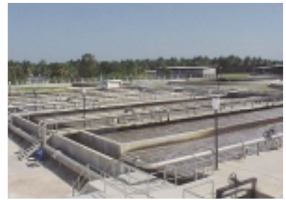
(ก.) ระบบบำบัดน้ำเสียแบบยัดเวลาเดิมอากาศ (เมืองพัทยา)
