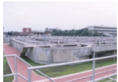
(ข.) ระบบบำบัดน้ำเสียแบบคลองวนเวียน (เทศบาลนครนนทบุรี)
