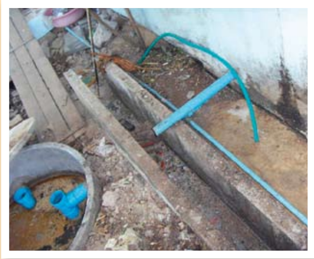
การต่อเชื่อมท่อน้ำเสีย กับถังดักไขมันที่ไม่ถูกต้อง
