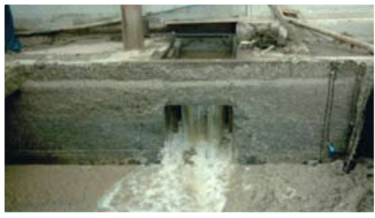
ลักษณะของน้ำก่อนเข้าระบบบำบัดน้ำเสีย
