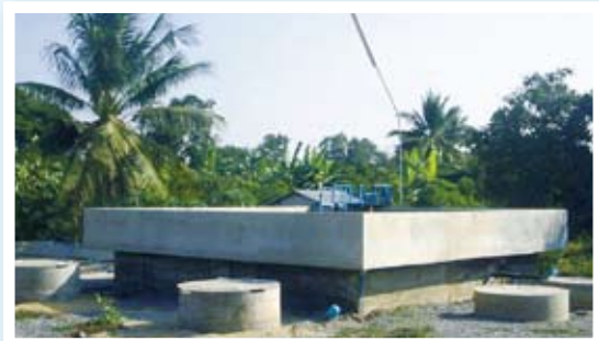
ระบบบำบัดน้ำเสียสาธิตแบบ ABR อำเภอเมือง จังหวัดสุพรรณบุรี
