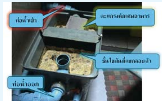
บ่อดักไขมัน
