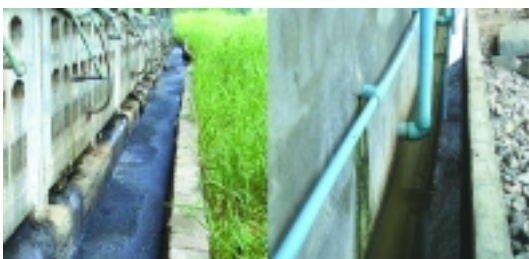
รางระบายน้ำอุดตัน
