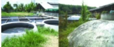
ระบบบำบัดน้ำเสียแบบโดมคงที่ (Fixed Dome)
