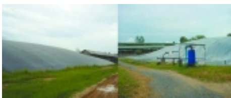
ระบบบำบัดน้ำเสียแบบพลาสติกคลุมบ่อ (Covered Lagoon)
