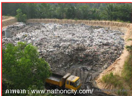
ภาพที่ 62 บ่อกลบฝังขยะที่ป้องกันการไหลของน้ำ เสียจากบ่อขยะออกไปสู่แหล่งน้ำธรรมชาติ ทั้งที่เป็น น้ำใต้ดิน และแม่น้ำ ลำคลองต่าง ๆ
