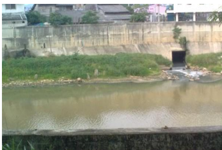
ภาพที่ 39 ท่อระบายน้ำทิ้งในคลองอุตะเถา ถ่ายเมื่อ 17 สิงหาคม 2555
