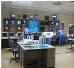
ห้องควบคุมการทำงาน ภายในศูนย์บำบัดฯ
