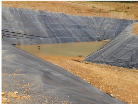
รูปที่ 4.1-16 สภาพทั่วไปของหลุมฝังกลบขยะมูลฝอยเทศบาลเมืองบ้านพรุ
