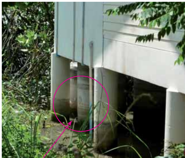
^ ท่อส้วม ที่ปล่อยน้ำเสียตรงลงสู่ทะเลสาบ
