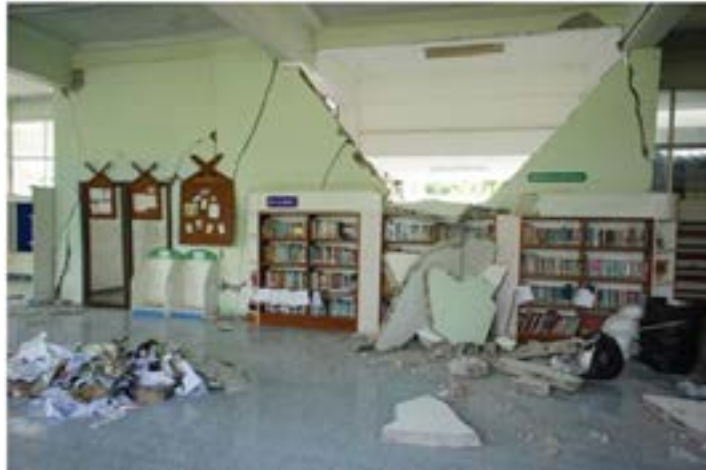
ภาพที่ 9 สภาพโรงเรียนพานพิทยาคม จังหวัดเชียงราย ได้รับความเสียหายและพังทลายลงมา ที่มา : สำนักเฝ้าระวังแผ่นดินไหว
