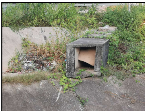
ภาพประกอบ 15 ทางระบายน้ำ เทศบาลนครหาดใหญ่
