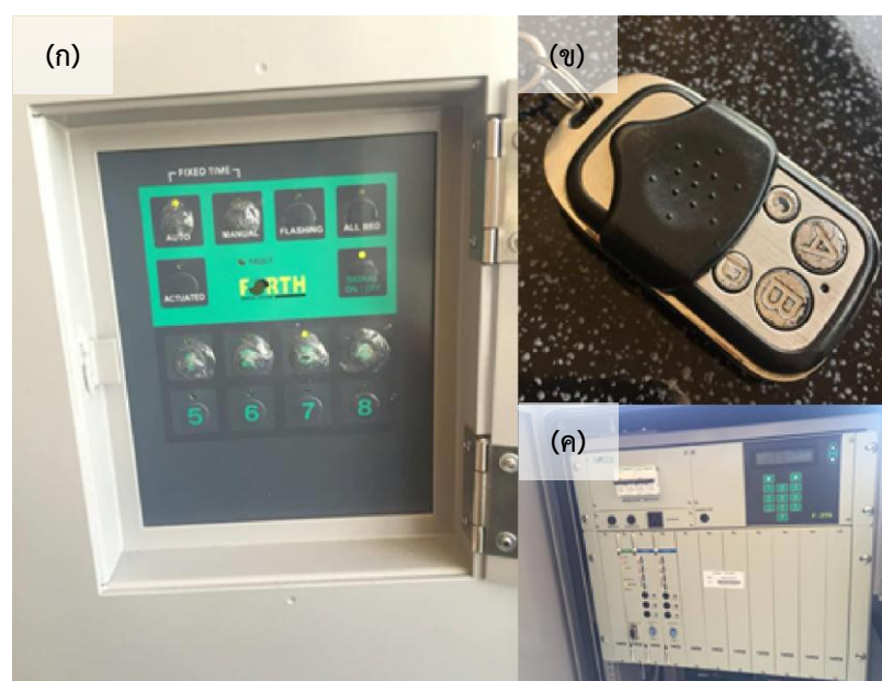
รูปที่ 3.7 ตู้อุปกรณ์ควบคุมจราจรจำนวนและรีโมทควบคุมสัญญาณไฟจราจร
