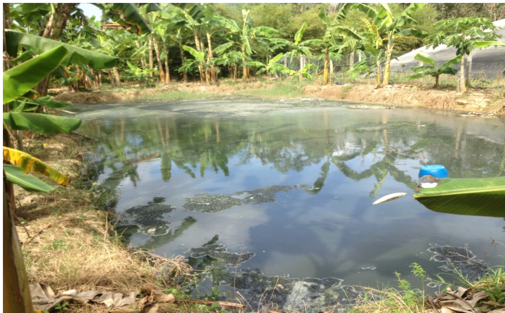
ภาพที่ 4.28 บ่อบำบัดน้ำเสียสหกรณ์กองทุนสวนยางบ้านเก่าร้าง
