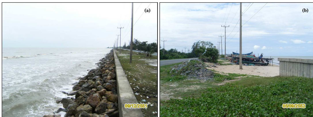
รูปที่ 3-6 กำแพงกันคลื่นแบบเข็มพืด (a) และช่องว่างระหว่างกำแพง (b) ดำเนินการก่อสร้างโดยกรมทางหลวง
