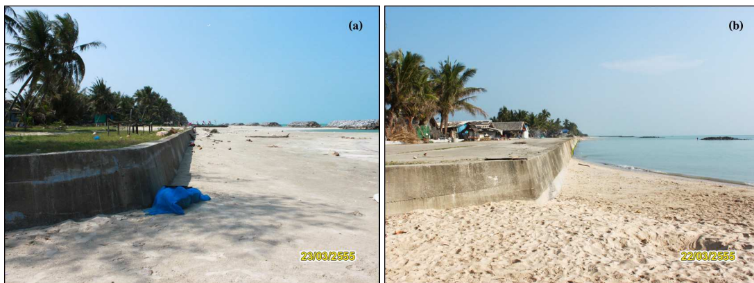
รูปที่ 3-36 กำแพงคอนกรีต บริเวณบ้านหน้าสวน (a) และบ้านแพรงเมือง (b) ดำเนินการก่อสร้างโดยกรมโยธาธิการและผังเมือง
