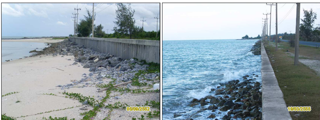
รูปที่ 3-11 การทรุดตัวของแนวหินทิ้ง ด้านหน้ากำแพงกันคลื่น ช่วงบ้านหน้าโกฏิถึงบ้านเกาะฝ้าย
