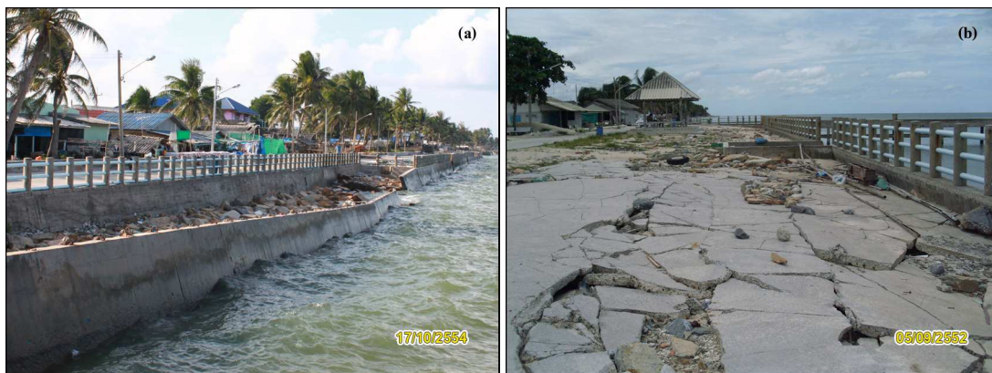
รูปที่ 3-44 การทรุดตัวของกำแพงคอนกรีตด้านเหนือท่าเทียบเรือประมง (a) และความเสียหายของพื้นคอนกรีตด้านหลังกำแพง (b)
