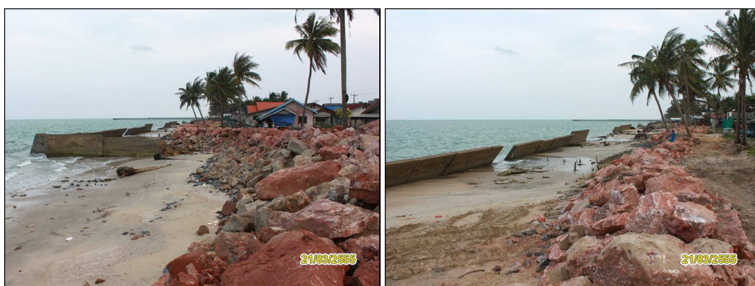
รูปที่ 3-46 การพังทลายของกำแพงคอนกรีต และการวางแนวหินทิ้งป้องกันตลิ่ง บ้านหน้าศาลเหนือ
