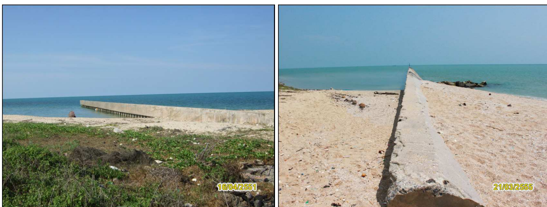
รูปที่ 3-4 เชือกกันทรายปากคลองพังทลาย บ้านบ่อคณทิ ดำเนินการก่อสร้างโดยกรมชลประทาน
