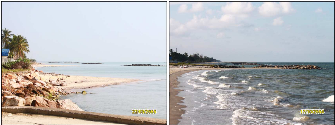
รูปที่ 3-42 สภาพชายฝั่งบ้านแพรกเมืองถึงบ้านหัวท่าเงิน (a) และความเสียหายของรอดักทรายรูปตัวที่ (b)
