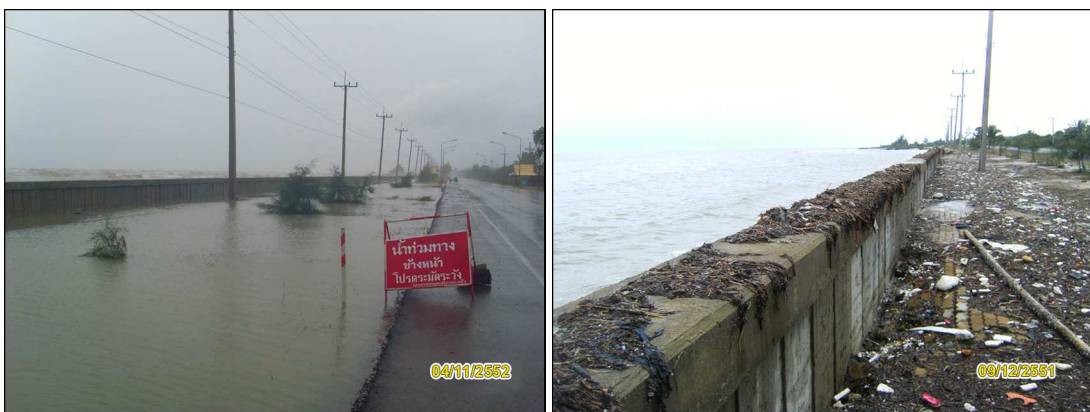
รูปที่ 3-13 ความเสียหายจากคลื่นลมแรงในช่วงมรสุมตะวันออกเฉียงเหนือ บริเวณกำแพงกันคลื่น แบบเข็มพืด ช่วงบ้านหน้าโกฏิถึงบ้านเกาะฝ้าย
