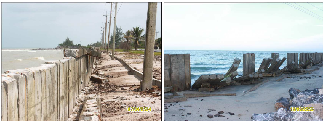
รูปที่ 3-14 ความเสียหายของกำแพงกันคลื่นแบบเข็มพืด บ้านหน้าโกฏิถึงบ้านเกาะฝ้าย
