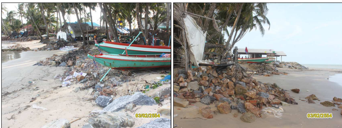
รูปที่ 3-21 ความเสียหายของแนวหินทิ้งป้องกันคลื่น บ้านหนองมนต์
