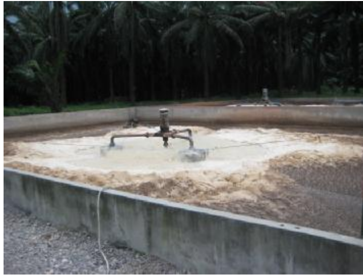
ภาพประกอบที่ 21 บ่อเติมอากาศสำหรับการบำบัดน้ำเสียขั้นต้น
