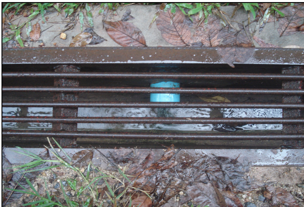
ภาพประกอบที่ 5 น้ำเสียที่ไหลออกจากท่อน้ำทิ้งที่ไม่ผ่านการบำบัดใดๆ ของแฟลตบุคลากรอาคาร 4
