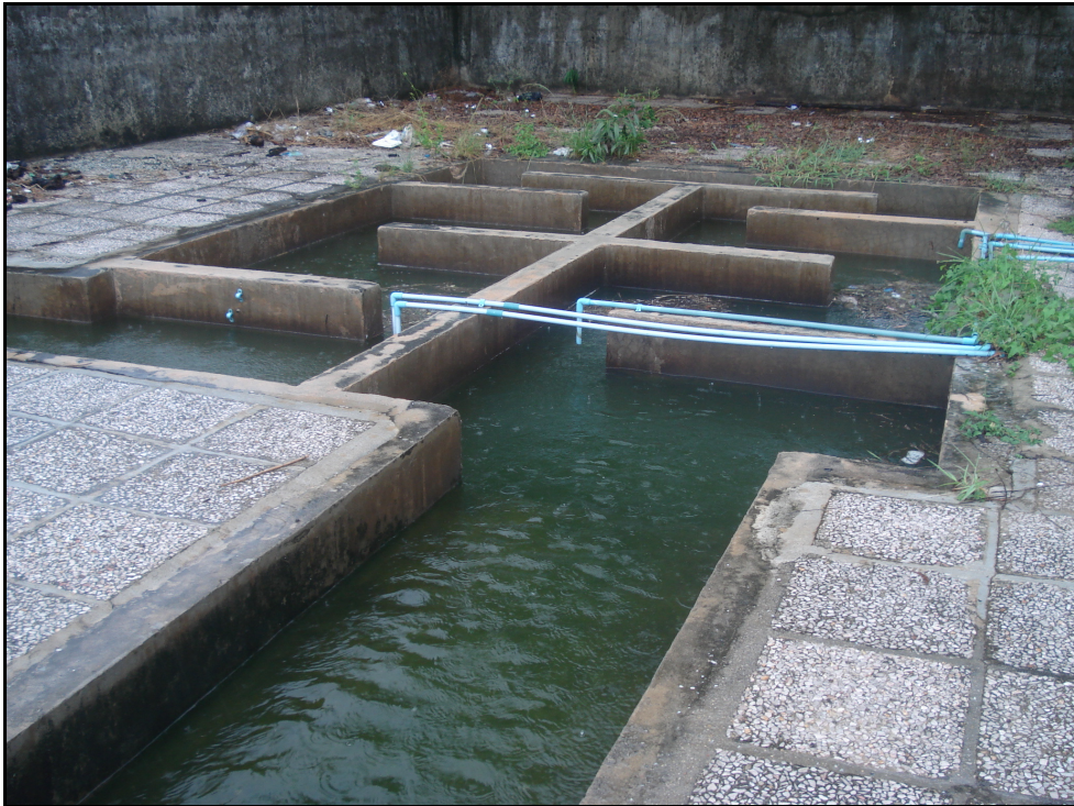
ภาพประกอบที่ 12 ลักษณะของบ่อเติมคลอรีนของระบบบำบัดน้ำเสียโรงพยาบาลสงขลานครินทร์
