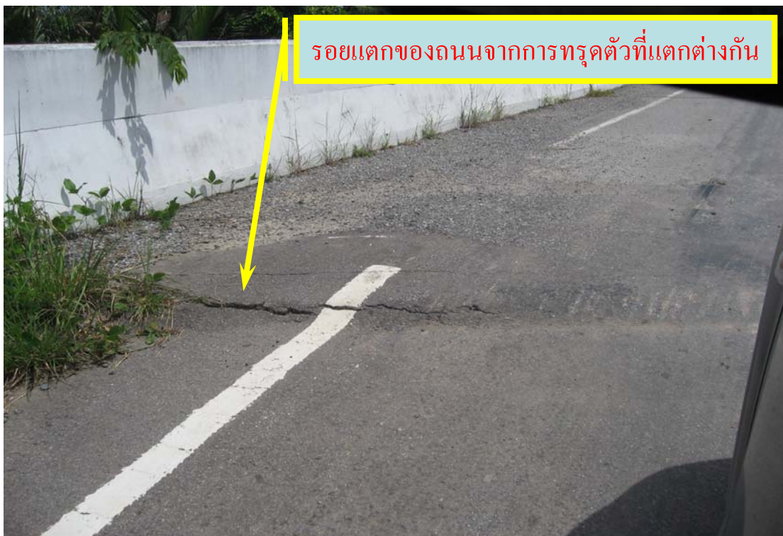
รูปที่ 1.2 การทรุดตัวของถนนบนชั้นดินเหนียวอ่อน
