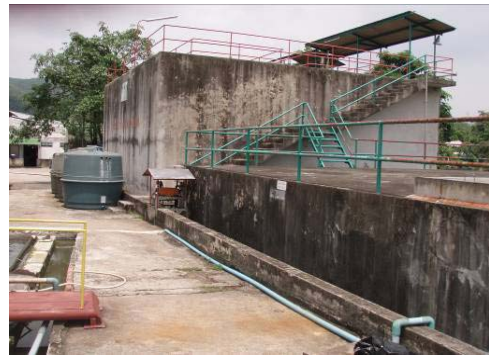
ภาพที่ 3.3 ระบบบำบัดน้ำเสียยูเอสบี
