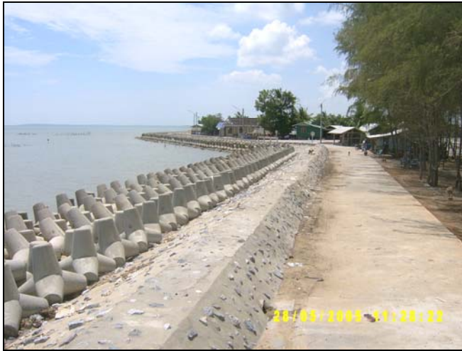
ก. กำแพงกันคลื่นและ ก้อนคอนกรีตปิดล้อม หมู่บ้านประมง บริเวณบ้านบางตา
