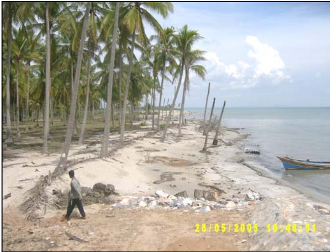
ก. สภาพการกัดเซาะตาม ชายหาดและสวนมะพร้าว ทางชายฝั่งตอนบนของ กำแพงกันคลื่น บ้านต้นหยงเปาว์
