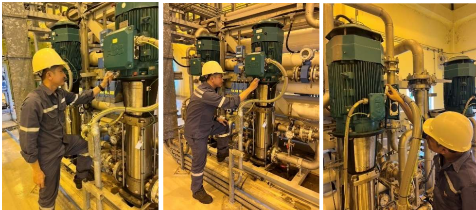
ภาพที่ 23 ตัวอย่างระหว่างทำการ VIBRATION & TEMP. CHECK of RO Pump
