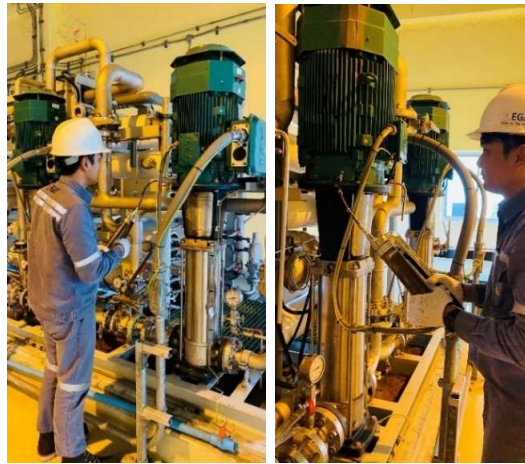
ภาพที่ 22 ตัวอย่างระหว่างทำการ GREASE FILL of RO Pump
