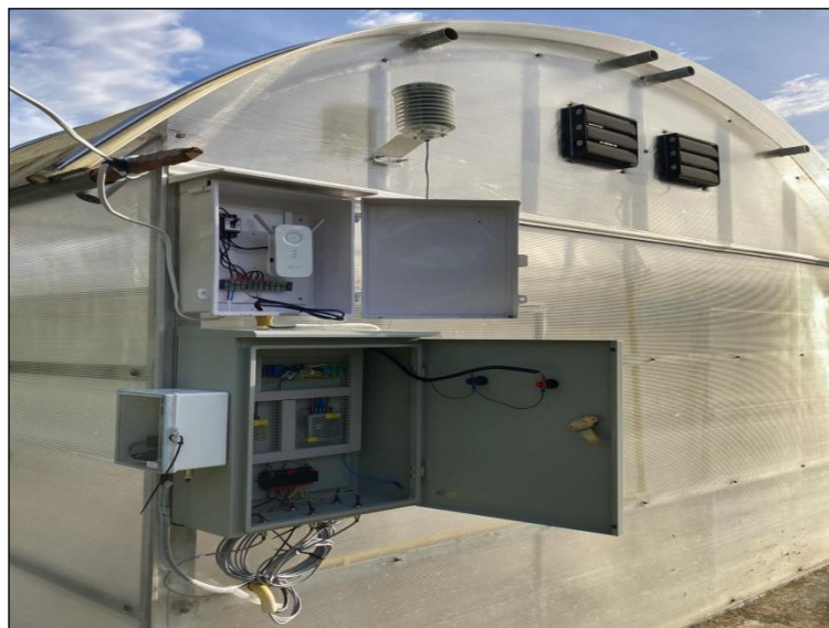
ภาพที่ 4.6 การติดตั้งอุปกรณ์ของระบบควบคุมไอโอที ในโรงอบแห้งฯ
