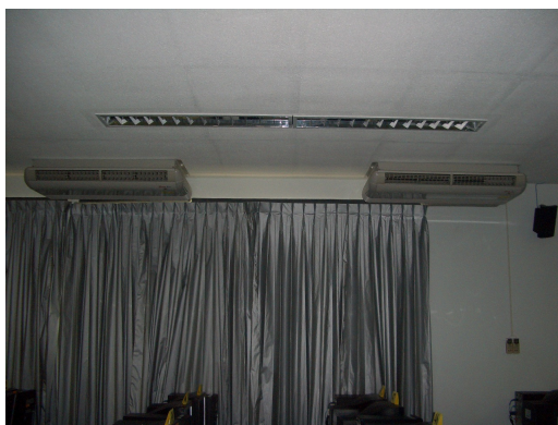
ภาพประกอบที่ ซ.5 แสดงการติดตั้งระบบเครื่องปรับอากาศด้านในอาคาร
