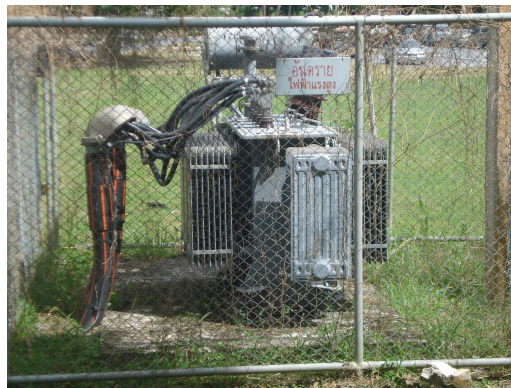
ภาพประกอบที่ ซ.2 แสดงการติดตั้งหม้อแปลงไฟฟ้า
