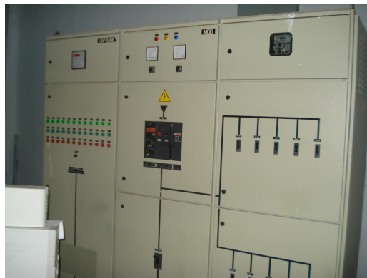
ภาพประกอบที่ ซ.3 แสดงการติดตั้งมิเตอร์และระบบควบคุมไฟฟ้า
