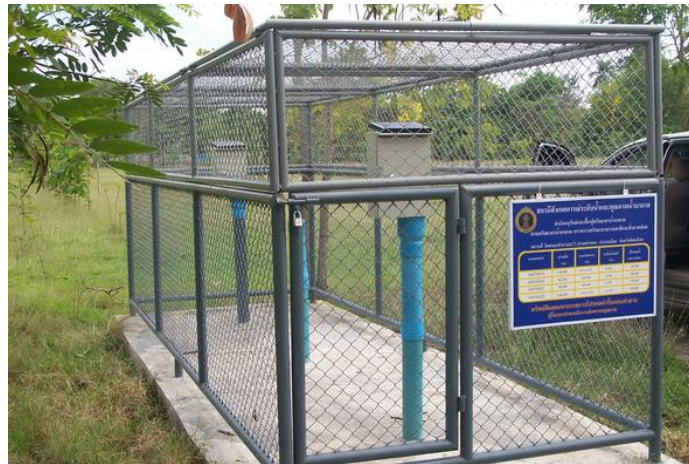
รูปที่ 2.7 สถานีสังเกตการณ์น้ำบาดาลติดตั้งเครื่องบันทึกระดับน้ำอัตโนมัติ
