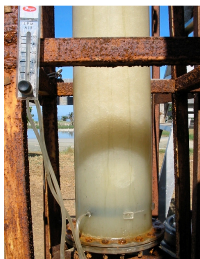
รูปที่ 4.11 ภาพ ระบบลอยตะกอนขณะทำการลอยตะกอน แสดงให้เห็นหัวทรายที่ทำให้เกิดฟองอากาศ
