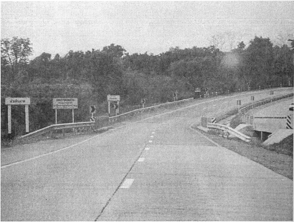
รูปที่ ก 4 : ไหล่ทางที่ขาดความต่อเนื่องในบริเวณสะพาน
