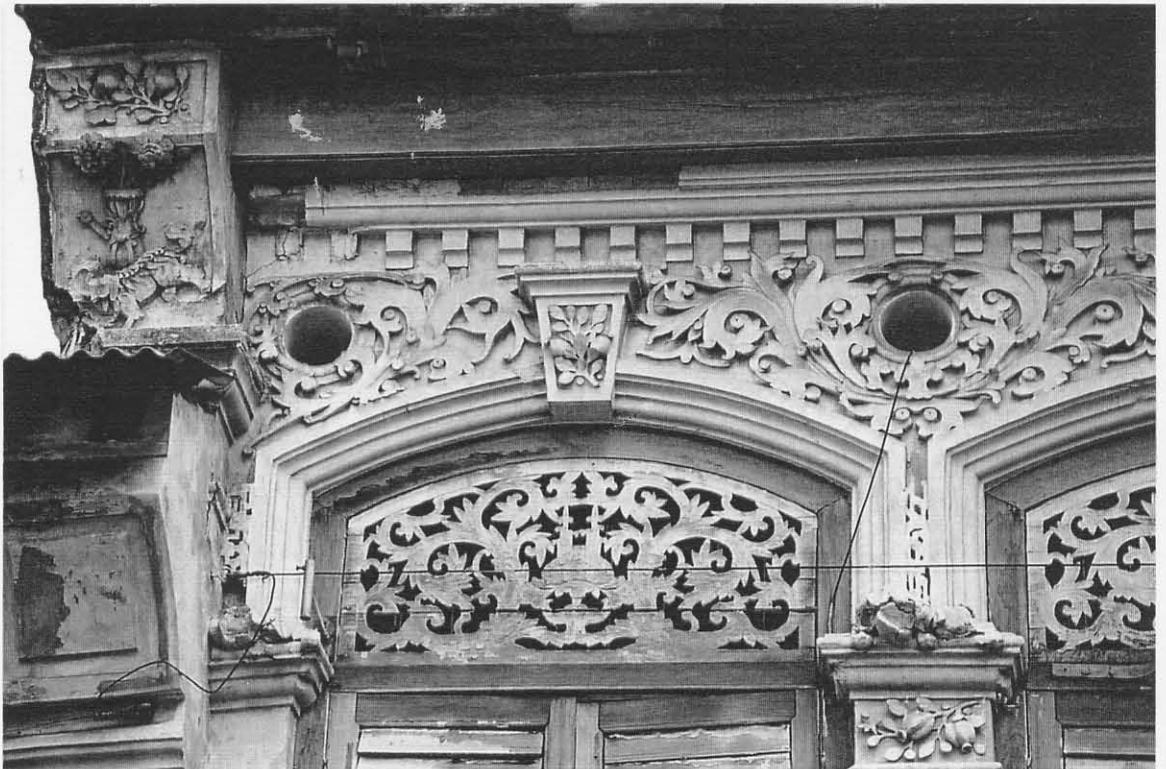
เหนือหน้าต่างตกแต่งลายเทพฤทษยา ตัวกรอบช่องวงกลมซึ่งเป็นช่องลม บนเสาอิง ระหว่างหน้าต่างเป็นผลทับทิม หัวเสาชั้นชายคาซ้ายสุดตกแต่งไม้ผลแจกันและสิงห์
