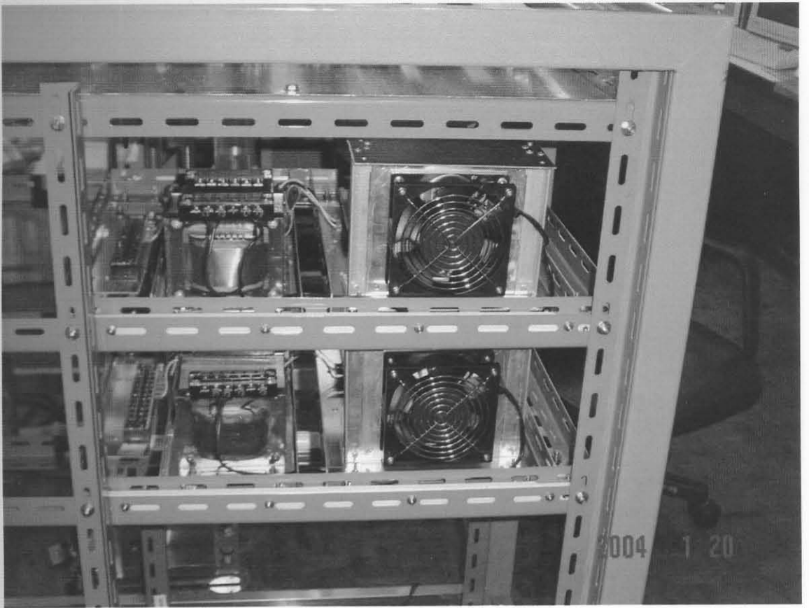
รูปที่ 22 แสดง speed controller power driver unit rack ที่ติดตั้งบนโครงสร้างตามรูปที่ 15
