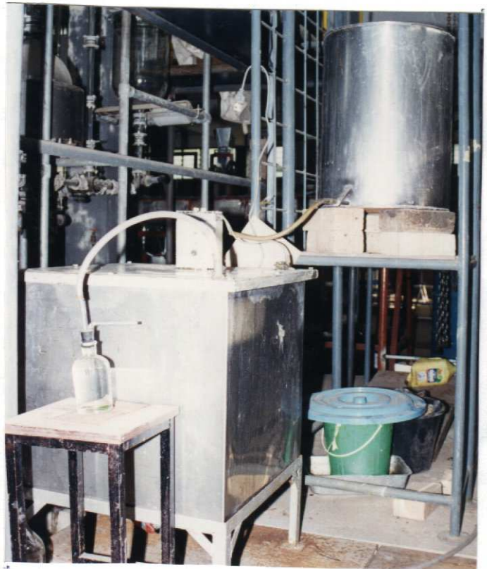
รูปที่ 11 ระบบบำบัดน้ำดื่ม
