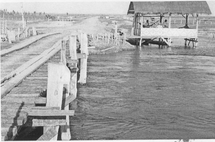
ภาพ ค7 กระแสน้ำเชี่ยวที่สะพานถนนสาย พท. 3037 ตัดกับคลองบ้านกลาง
