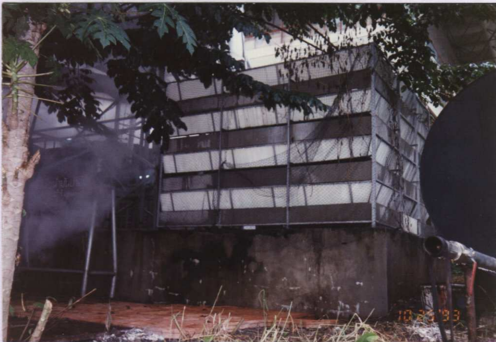
รูปที่ 3.17 ทอฝั่งเย็นและบ่อน้ำหมุนเวียน
