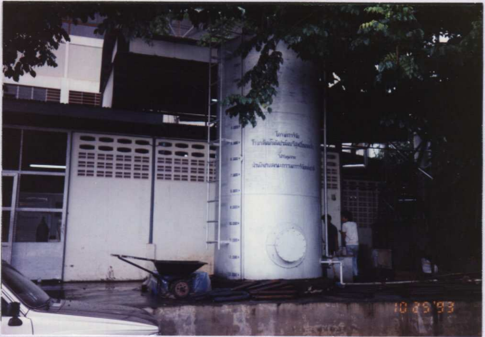
รูปที่ 3.5 ถังเก็บน้ำมันปาล์มดิบ
