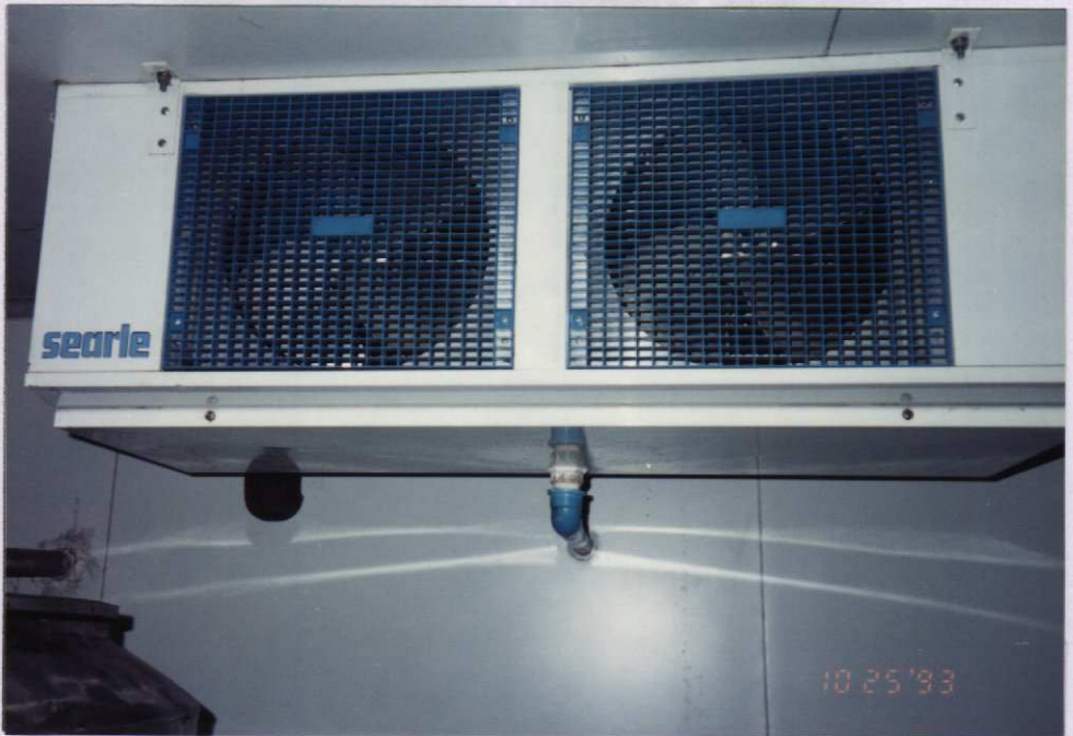
รูปที่ 3.14 พัดลมคอลย์เย็น
