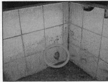
รูปที่ 6 รูที่เจาะเพื่อนำน้ำไปใช้ล้างพื้น
