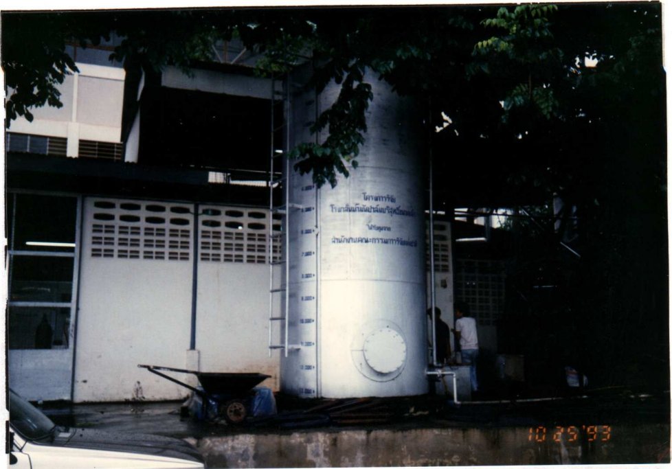
รูปที่ 3.2 ถังเก็บน้ำมันปาล์มดิบ
