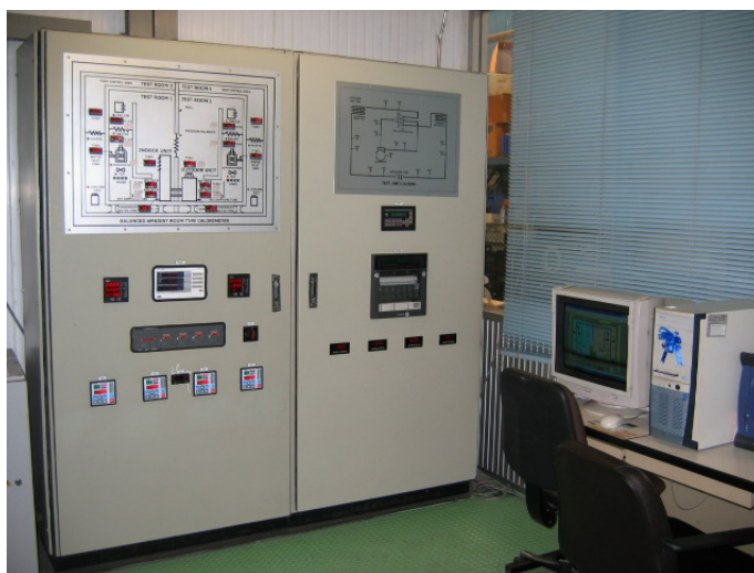
รูปที่ 3.13 แสดงตู้ควบคุมการทำงานของอุปกรณ์ภายในห้องและคอมพิวเตอร์ที่ใช้สำหรับควบคุม
