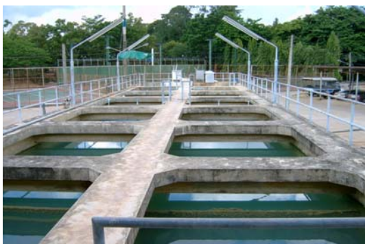
ถังตกตะกอนระบบทรายกรองเร็ว (RST)
