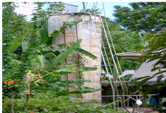
ถังเติมสารส้มทั้ง 2 ระบบ (AT)
