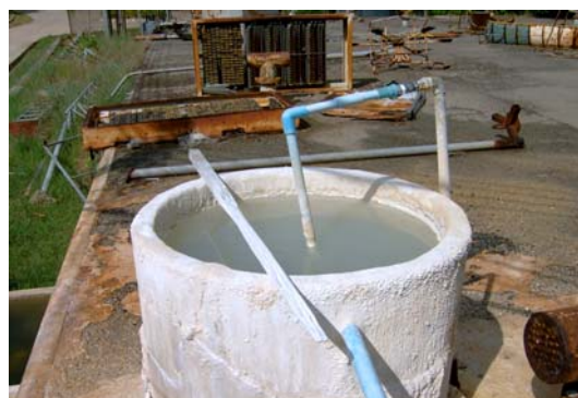
ถังเติมคลอรีน (D)
