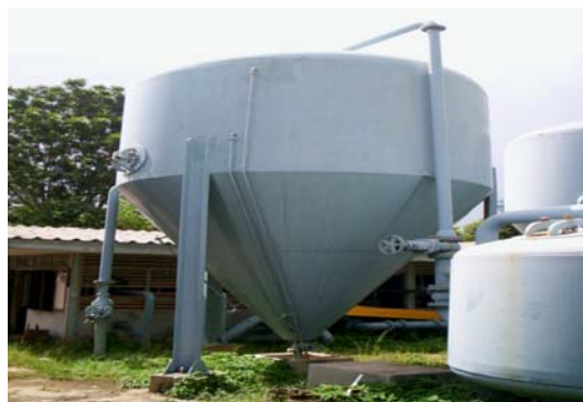
ถังตกตะกอนระบบกรองแบบใช้แรงดัน (PST)
