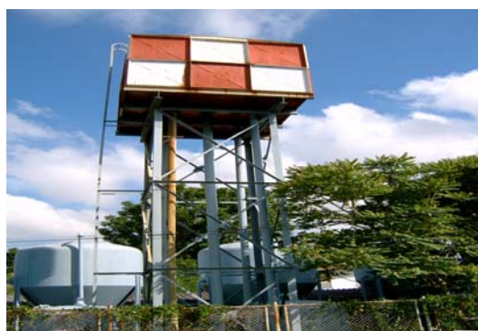
ถังสูงระบบกรองแบบใช้แรงดัน (T)
