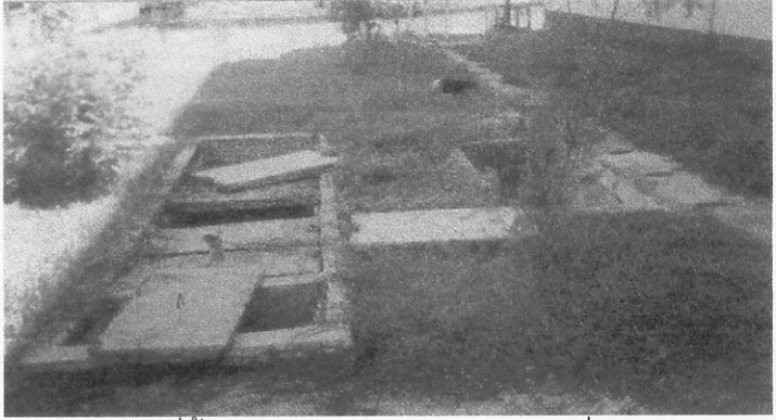
ก. ลักษณะที่ตั้งของบ่อดักไขมันและตะแกรง ซึ่งไหลมาจากครัว
