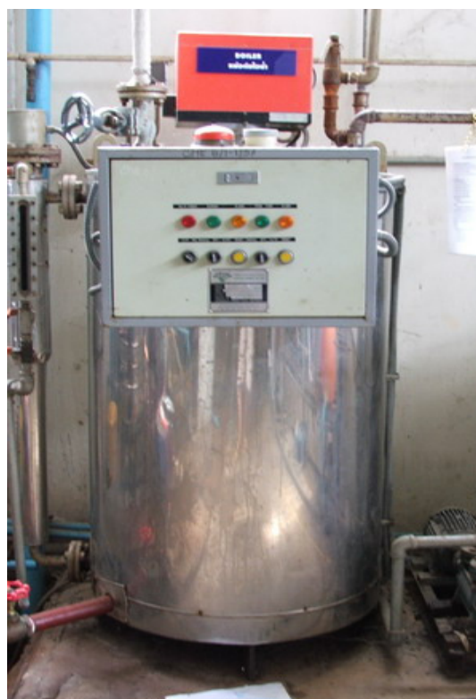
ภาพประกอบที่ ง-12 หม้อต้มน้ำ (boiler)
