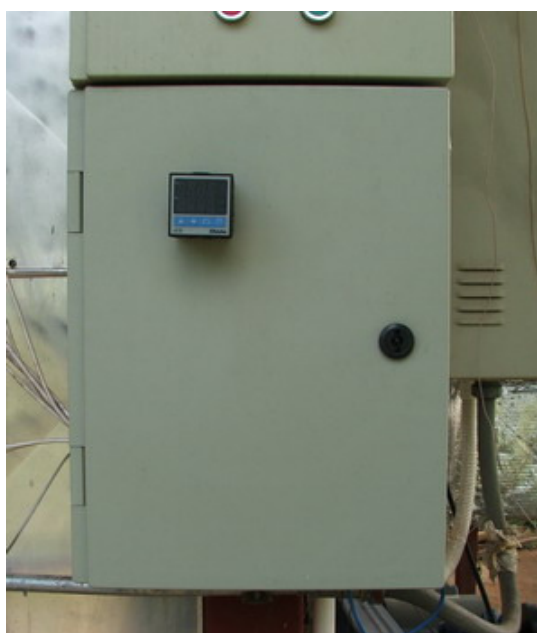
ภาพประกอบที่ ง-6 กล่องควบคุมเครื่องทำความร้อนภายในห้องอบไม้ยาง
