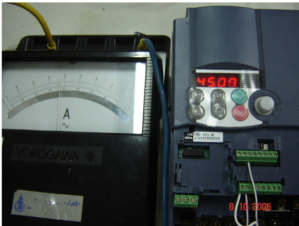
ภาพประกอบ 4-6 ผลการทำงานของอินเวอร์เตอร์เมื่อปริมาณโหลดค่าปานกลาง
