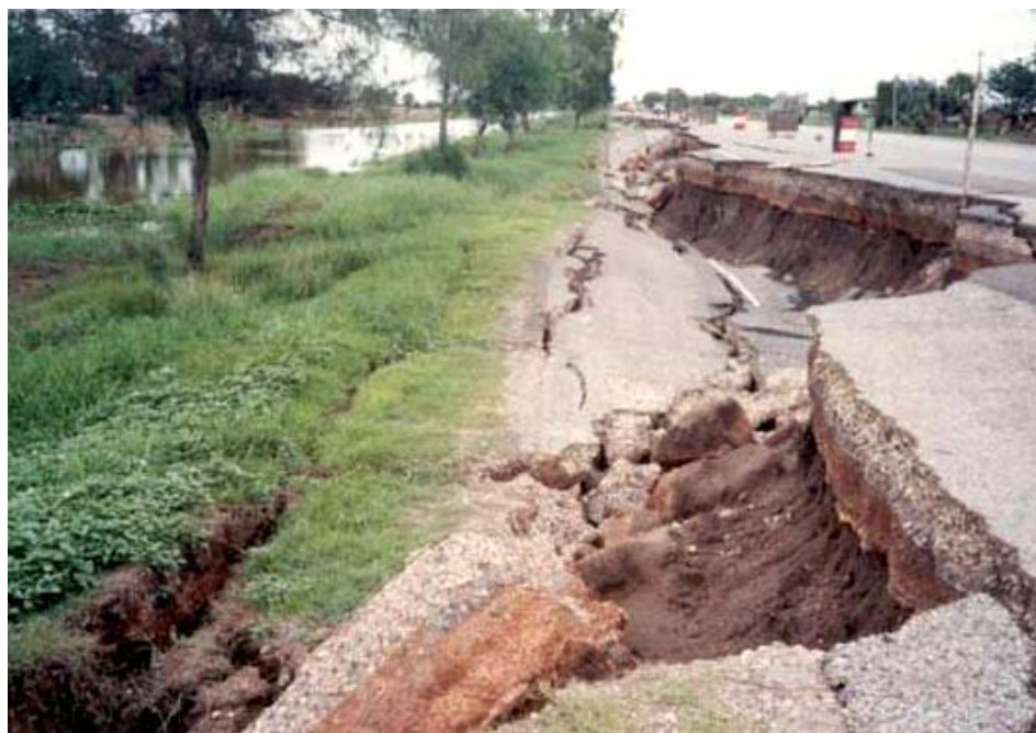
รูปที่ 1.2 การวิบัติของถนนแบบเสถียรภาพความลาด เนื่องจากการก่อสร้างถนนบนชั้นดินอ่อน
