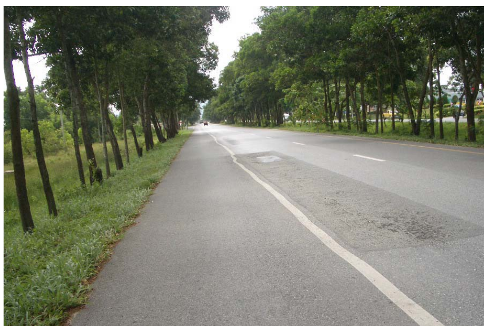
รูปที่ 1.3 การวิบัติของถนนแบบร่องล้อ ถนนเกิดการทรุดตัวบริเวณที่แนวล้อรถวิ่งผ่านซ้ำๆกัน เนื่องจากการก่อสร้างถนนบนชั้นดินอ่อน
