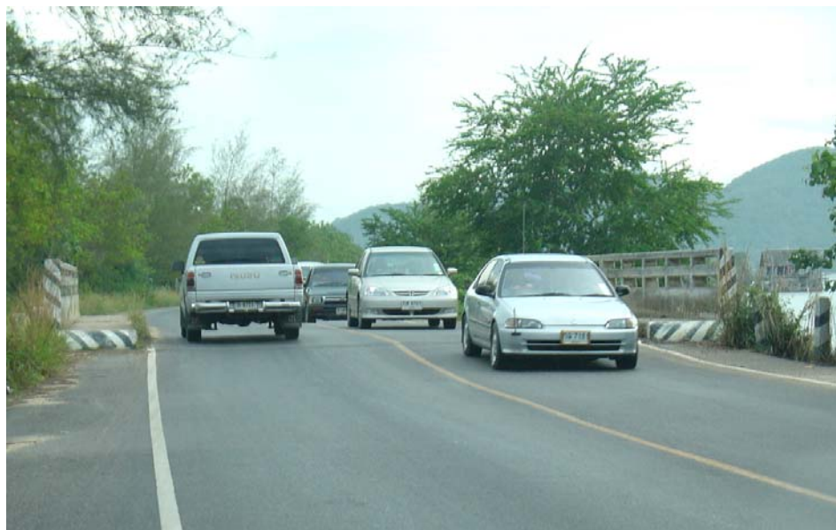
รูปที่ 1.1 การทรุดตัวของถนนบริเวณคอสะพาน เนื่องจากการก่อสร้างถนนบนชั้นดินอ่อน
