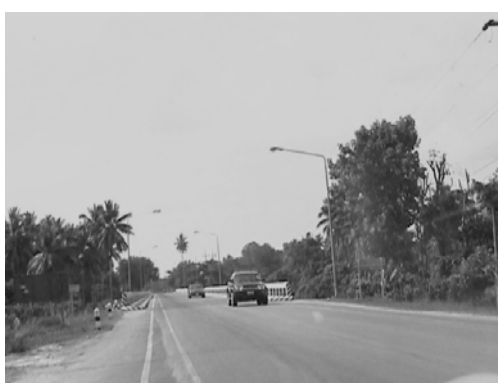
ง) ไม่มีราวกันชนบริเวณหัวสะพานแยก ม.4
